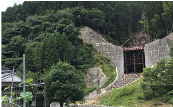
砂防堰堤（Jスリット） 柚ノ木川砂防堰堤（捕捉直後の写真） 谷出口に設置された本堰堤は、H29九州北部豪雨による 土石流・流木を捕捉し、直下流の人家を保全した。 （大分県日田土木事務所管内；大分県日田市鶴河内）
