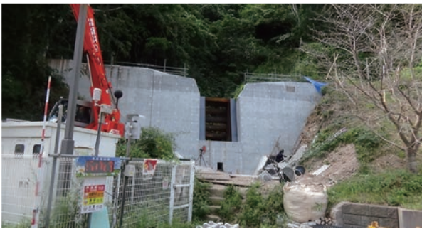
写真-4 上=裏山に建設する砂防堰堤で守られる総合病院 下=避難所になる学校体育館の裏で進む砂防堰堤工事
