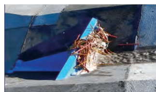
不透過型砂防堰堤 (水通しから泥水とともに下流に流出)
