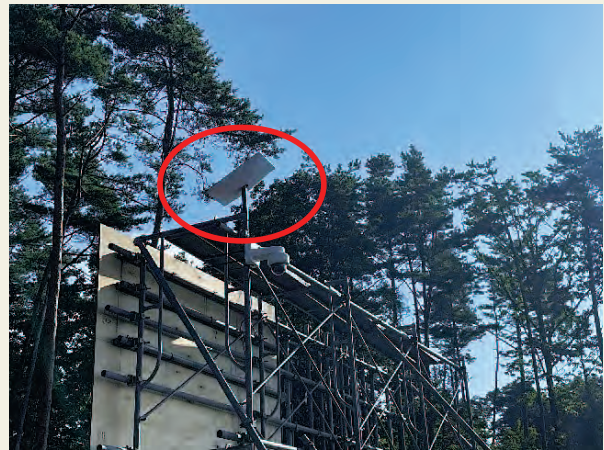
図-14 スターリンク設置状況
