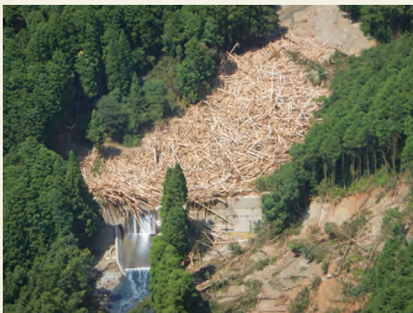
写真-1 福岡県朝倉市 妙見川 須川第1砂防堰堤
