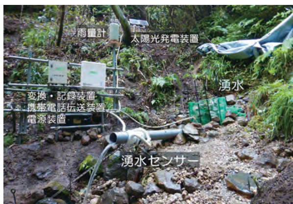
図-13 始良カルデラ壁に設置した湧水センサー
