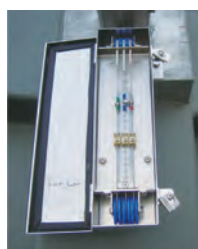
ECOM計測ボックス
