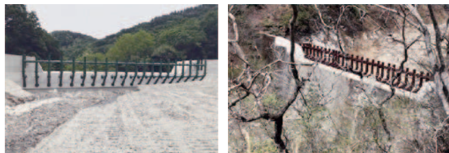
設置事例 (共に鋼製高3.0m) (左: 山梨県、右: 長野県)
