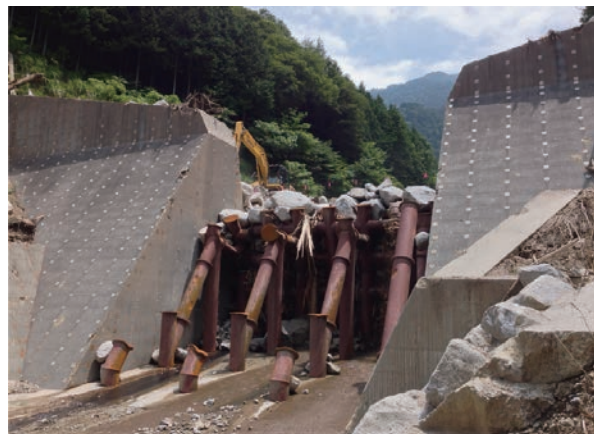
写真-2 レベル2荷重による損傷(梨子沢)
