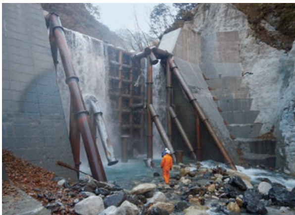
写真-1 レベル1荷重による損傷(大武川)
