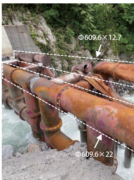
写真-3 鋼管板厚の違いによる損傷の差
