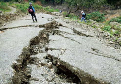
写真-8 右岸側斜面法肩周辺のクラック
