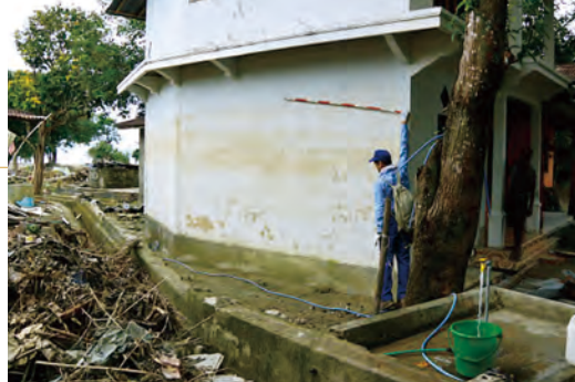
写真-9 右岸の洪水痕跡
