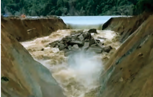
写真-3 余水吐の破損と非越流部からの崩壊開始
