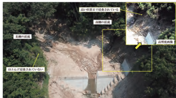
図-7 被災後の治山ダムの様子
