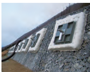
ECOM設置状況
