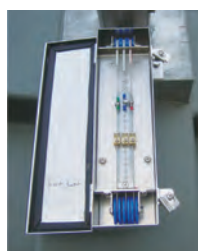
ECOM計測ボックス
