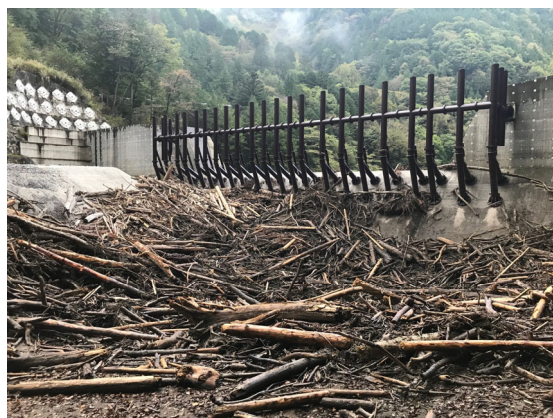
黒川砂防堰堤(天竜川上流河川事務所) (提供:JFE 建材株式会社)
