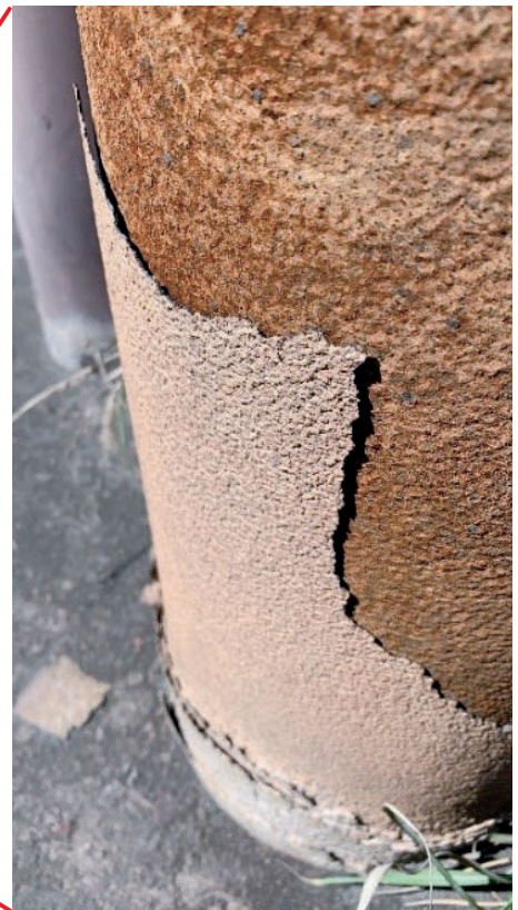
写真-3 無塗装鋼管の浮き錆び(拡大)
