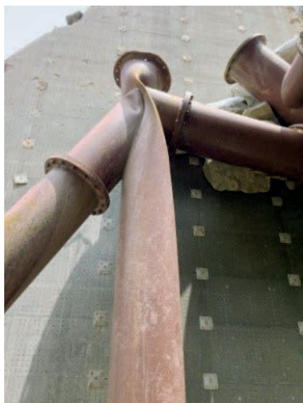
写真-1 最上流面より下流の部材のへこみ
