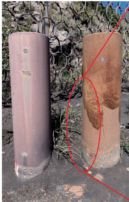
写真-2 塗装(左)と無塗装(右)の錆び方の差
